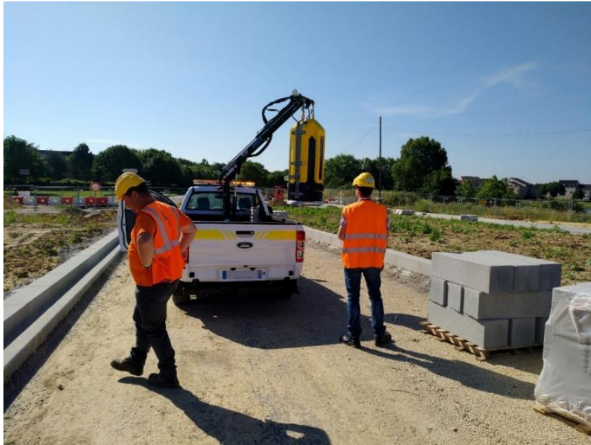
Déport à droite type grue
